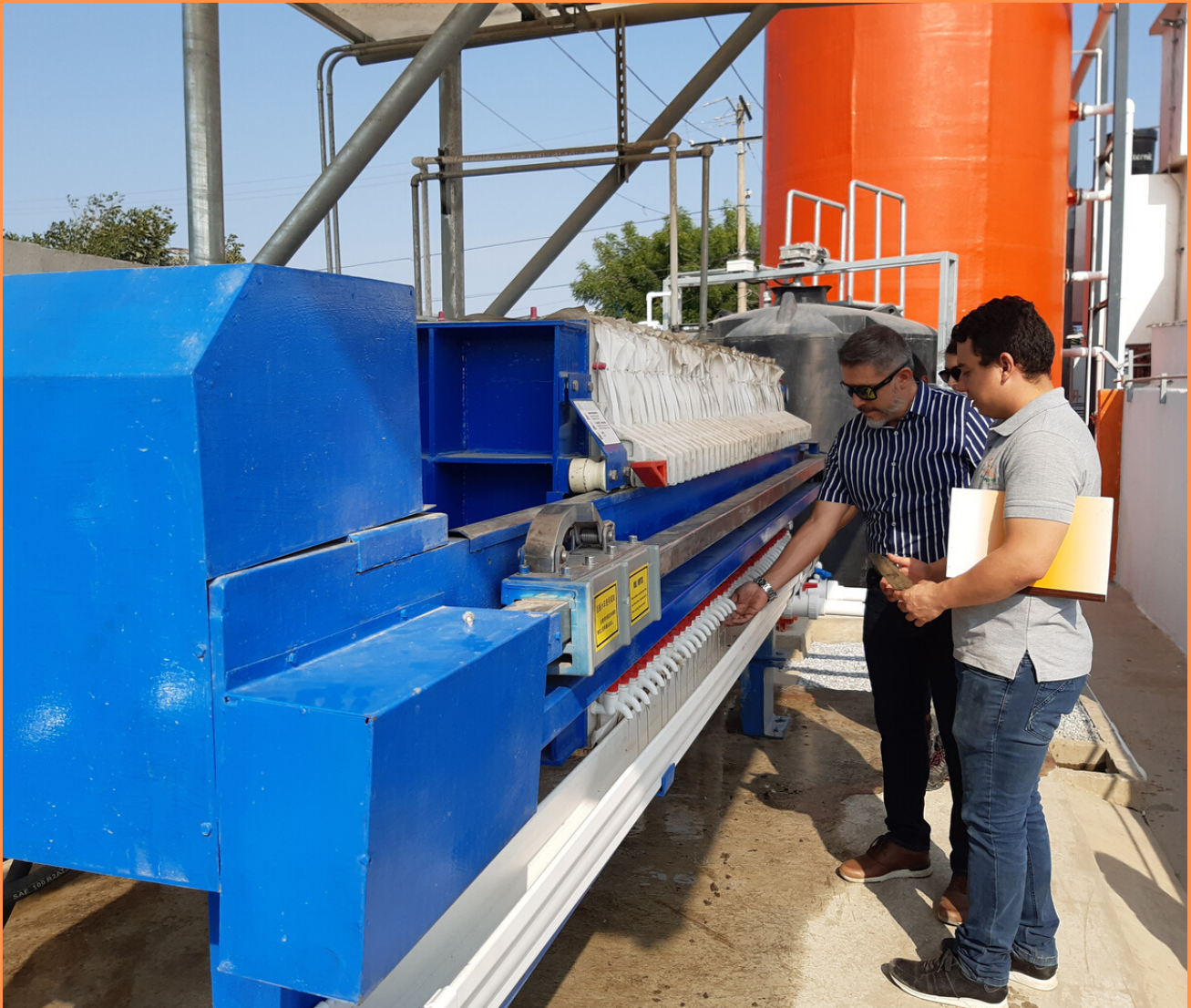
Sistema de tratamiento de lodos, Planta Concord
