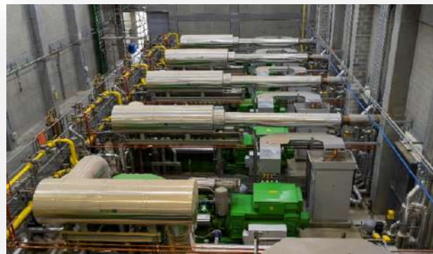
Figura 7. Motogeneradores para el autoabastecimiento de energía eléctrica
