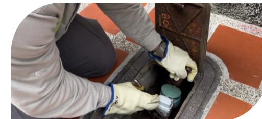
Foto: medidor de acueducto, Sucre
