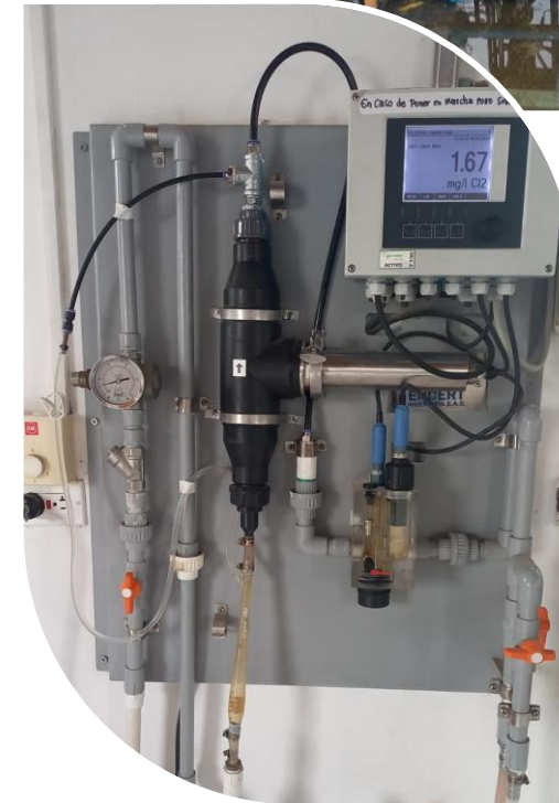
Ilustración: Montaje e integración de analítica (medición de pH, Cloro residual y turbiedad) en el agua potable a la salida de la PPAP de Apartadó.
