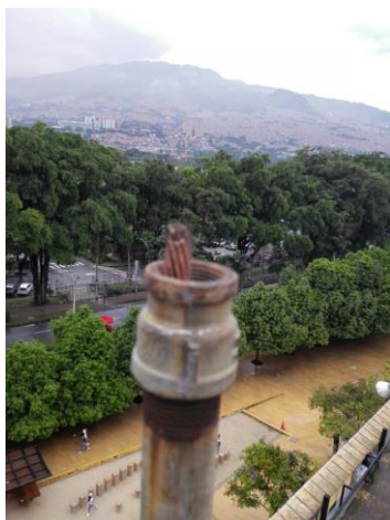
CABLE NO ALCANSA LA PUNTA PARARRAYO
