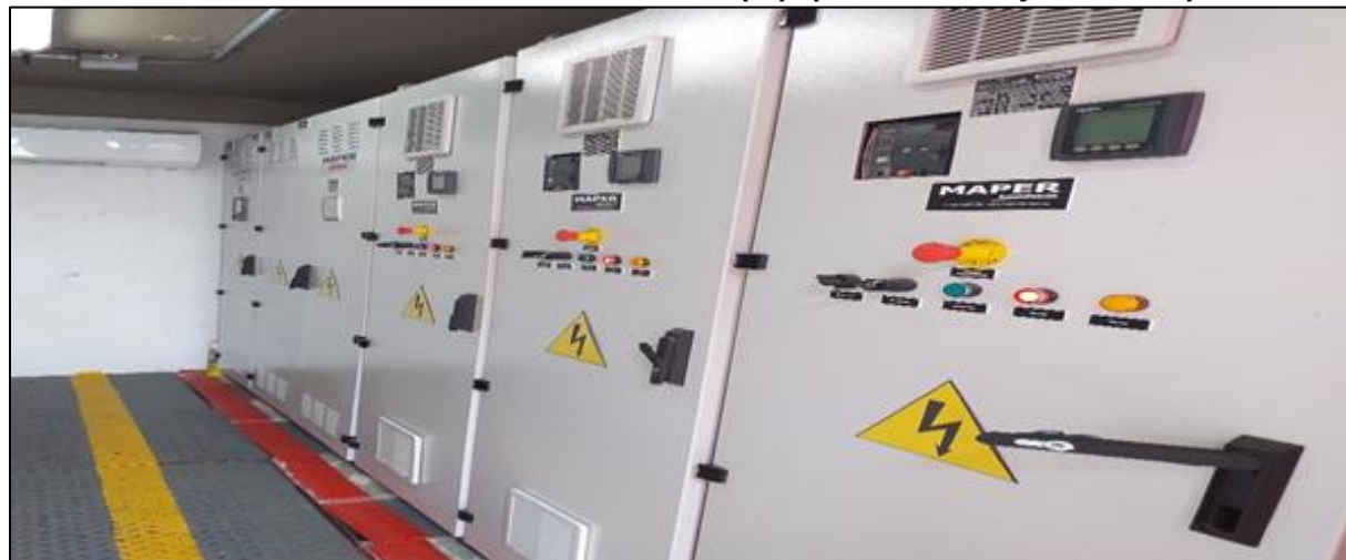
Imagen No. 14 Verificación en sitio del Plan de inversiones totales (Equipos eléctricos y de control)
