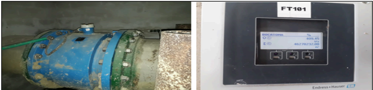
Imagen No. 31 Macromedidores (fotografías de campo)
