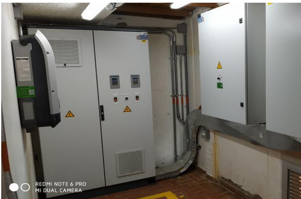
foto 2: Optimización sistema de control de la energía, inversor de energía solar
