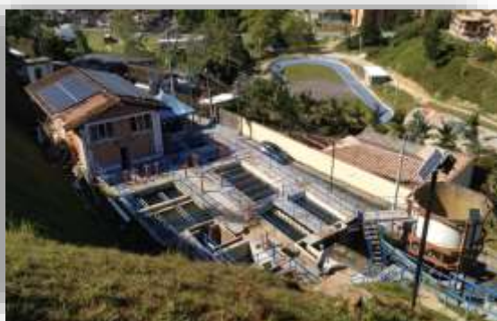
Panorámica de la planta de potabilización con las placas solares y torre de iluminación con placa solar.
