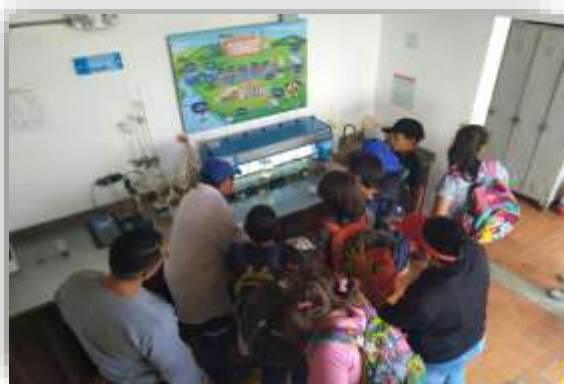
Sensibilización y educación ambiental en la planta de tratamiento de agua potable, niños de la escuela Alcaravanes.
