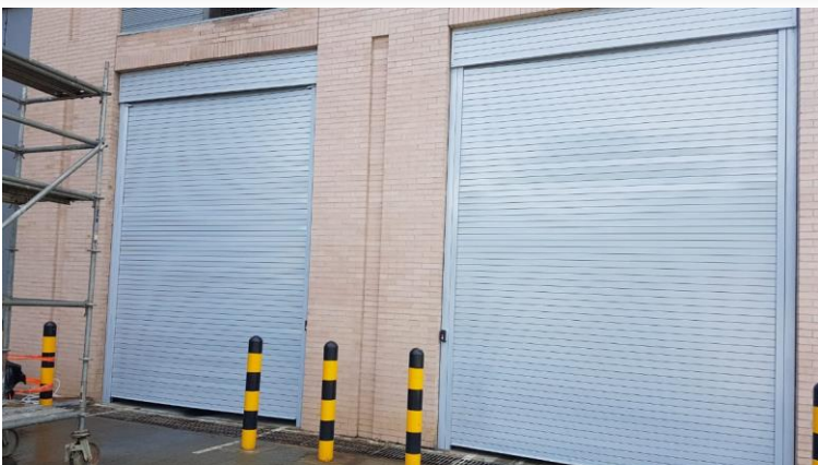
Seguimos avanzando en la mitigación de olores en la planta de tratamiento Aguas Claras EPM
