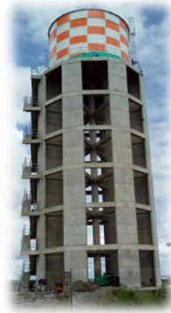
Tanque Zona Norte
