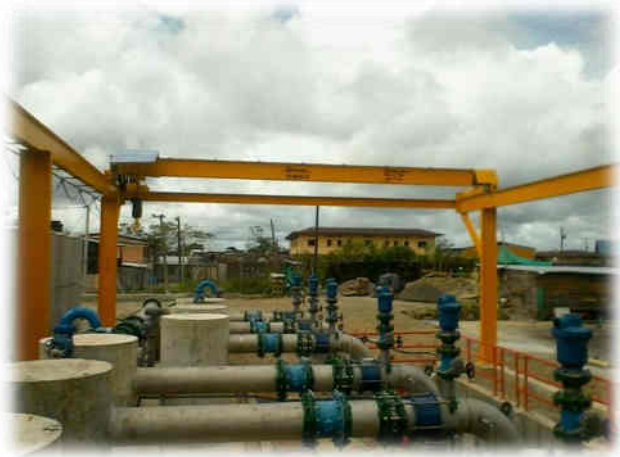
Estación de bombeo Zona Minera y Zona Norte y estructura de puente grúa.
