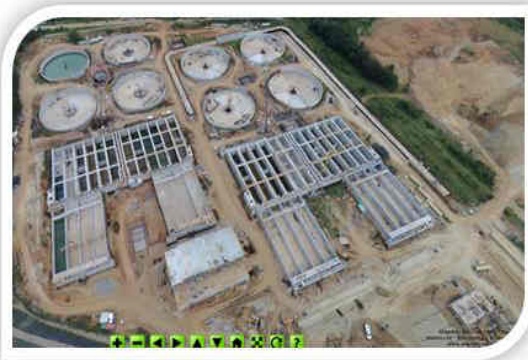
Tanques sedimentadores primarios, secundarios, tanques de aireación y canal de descarga.
