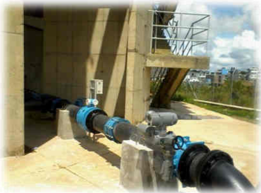
Sistema macromedición tanque Zona Minera
