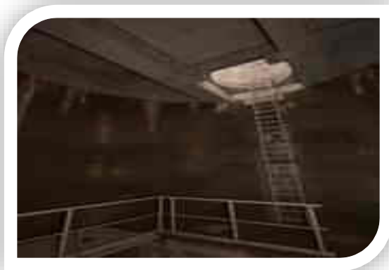
Estructuras metálicas construidas para facilitar operación y mantenimiento
