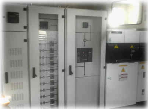
Subestación eléctrica Planta Playita
