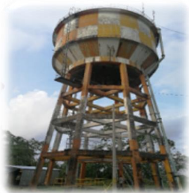
Fotografía 8.9 Tanques de almacenamiento Zona Norte y Zona Minera.
