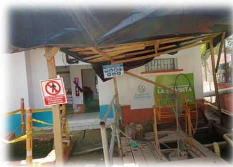
Fotografía 8.15 EBAR La Bombita.
