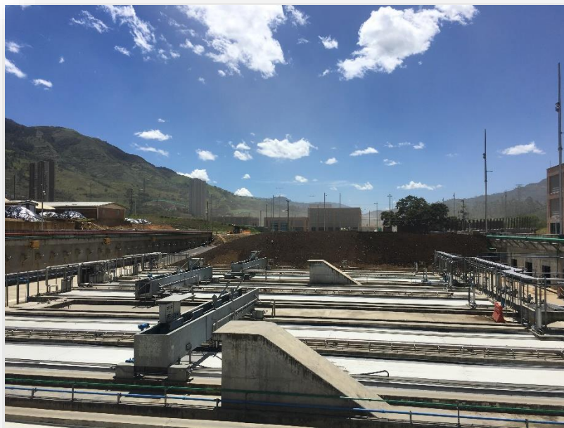
Figura 6. Sistema de desarenadores con sus respectivos puentes de drenaje A continuación, se presenta la cantidad de arenas y ordinarios gestionados:
