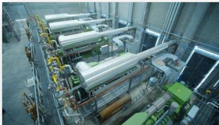
Figura 7. Motogeneradores para el autoabastecimiento de energía eléctrica
