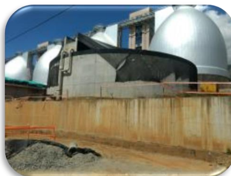
Tanques de almacenamiento y espesamiento de lodos
