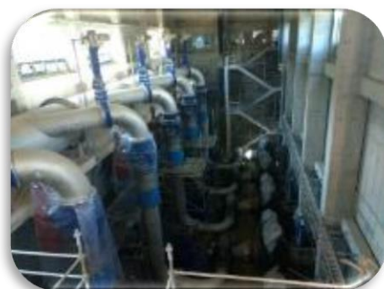
Estación de bombeo de entrada
