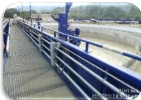
Tanques de sedimentación secundaria (TS)
