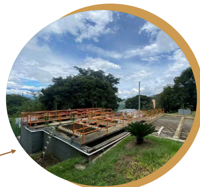
Planta de producción de agua potable (PPAP) del municipio de Sopetrán
