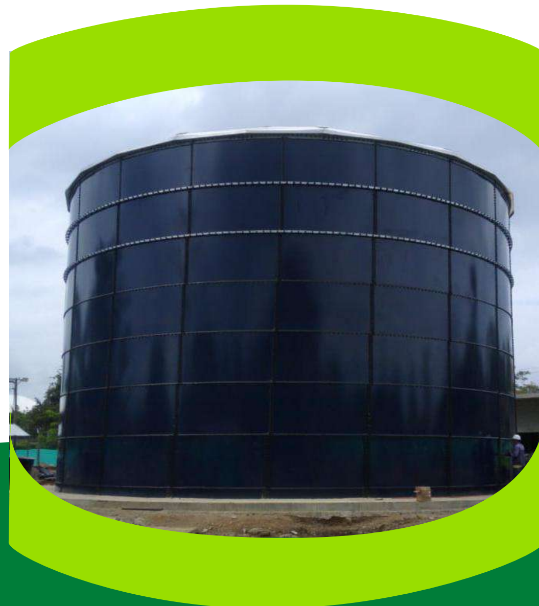
Tanque de almacenamiento de piso La Lucila II distrito de Turbo.
