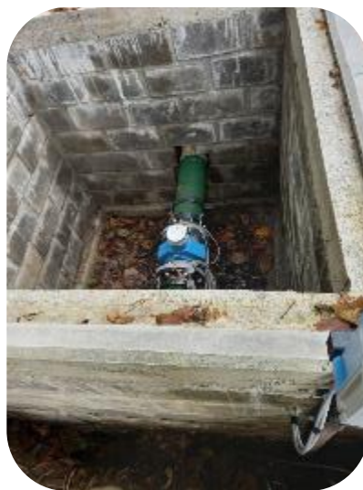
Montajes de macromedidores en bocatomas
