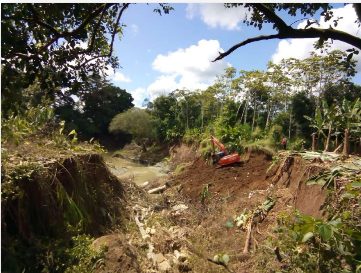
Daño en descarga plan parcial Meryland
