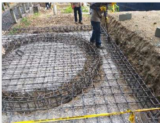
Tanque espesador de lodos Planta San Jerónimo.
