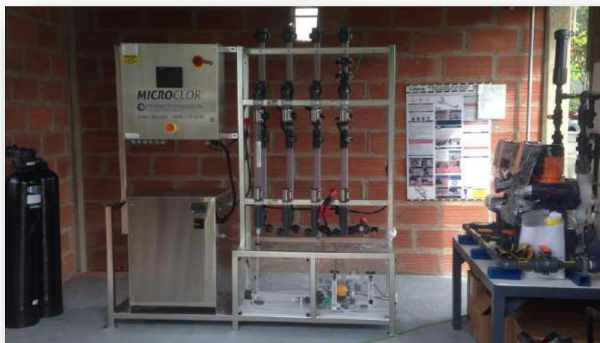
Equipo de generación de cloro instalado en Planta de Potabilización Santa Fe de Antioquia
