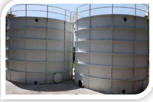
Tanques de almacenamiento El Recreo
