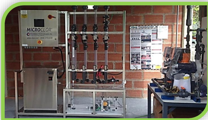
Planta de tratamiento de agua potable Municipio Santa Fe de Antioquia.
