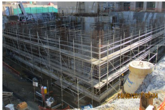
Instalación de acero de refuerzo en muro perimetral, columnas internas y columnas externas.
